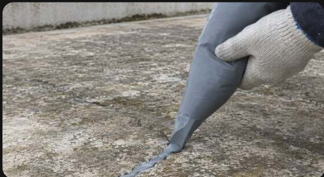
Después: fisuras selladas
